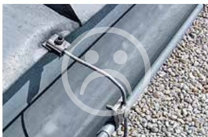
Instalacja odgromowa Mocowanie „na sztywno” = odkształcenia i pęknięcia od naprężeń
